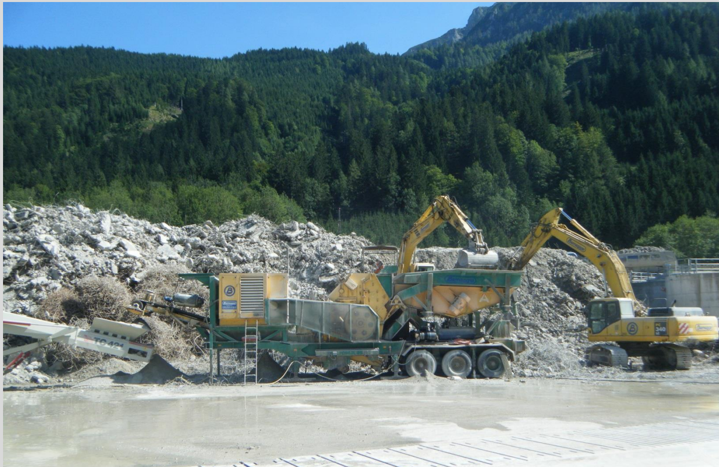
Zwischenlager in der Aufbereitungsanlage des AN Aufbereitung des Betonabbruchs mit einer mobilen Brecheranlage
