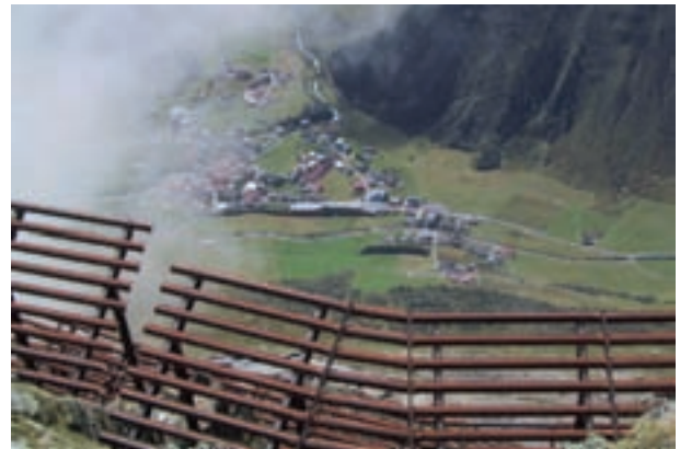
Opere di protezione antivalanga: 51 tratti a rischio valanghe, 221 ha. di superficie di detriti.
