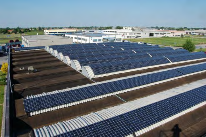
L'impianto fotovoltaico sul tetto della Martignani (Lugo, RA)
