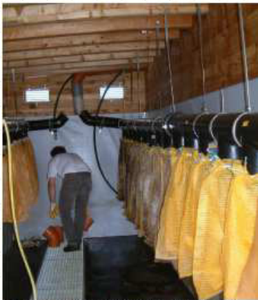
Abbildung 103: Filtersackanlage Bonn Matreier Hütte
