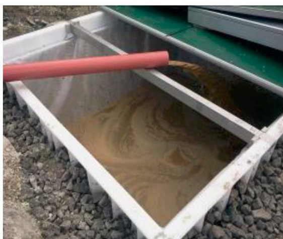
Esempio di vasche di essiccamento
