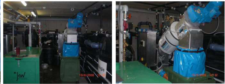
Abbildung 11: Nachgerüstete, mechanische Vorreinigung (HUBER Ro9)
